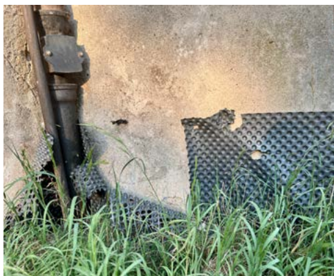
ryc. 8 Przykład szkodliwych i inwazyjnych prac przy ścianie fundamentowej renesansowego pałacu: obkopanie ściany budynku, umieszczenie folii luźno przyłożonej do muru tworzącej kieszenie na wodę opadową, która dostaje się w głąb muru
