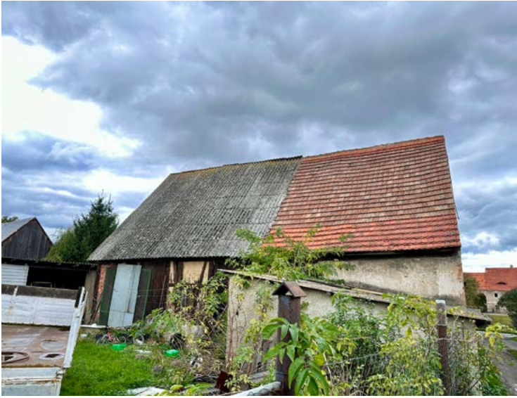
ryc. 7 Wtórne pokrycie dachu wykonane częściowo z płyty z eternitu falistego
