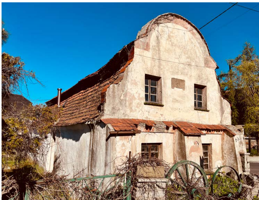
ryc.1 Zaniedbanie bieżących napraw w pokryciu dachu oraz odprowadzaniu wody opadowej stanowi jedno z największych zagrożeń dla stanu technicznego budynku
