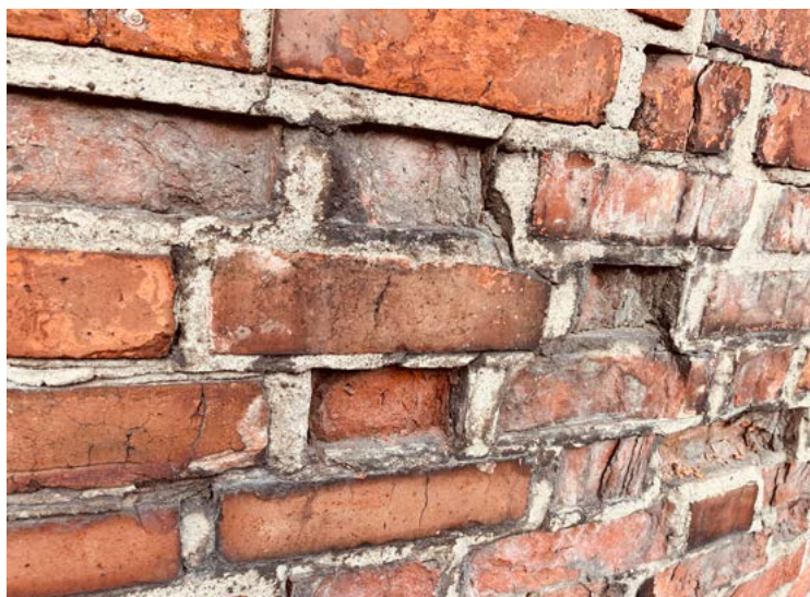
ryc. 14 Przykład uszkodzenia cegieł w murze poprzez wtórne wprowadzenie spoinowania zaprawą cementową
