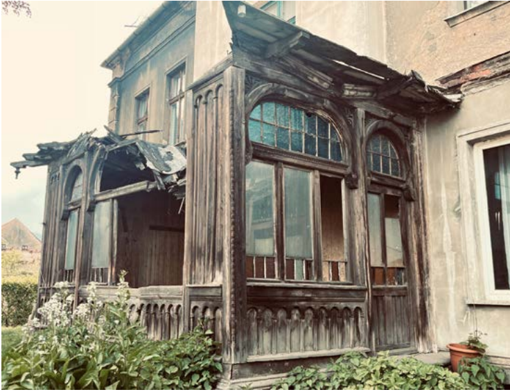
ryc. 5 Katastrofa spowodowana skrajnym zaniedbaniem
