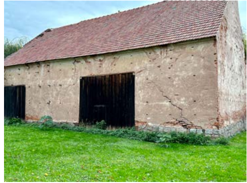
ryc. 4 Tak duże rozejście muru z pewnością niepokoi. Może wymagać naprawy poprzez zszycie, ale doświadczony inżynier konstruktor najpierw określi przyczynę i wskaże sposoby jej wyeliminowania
