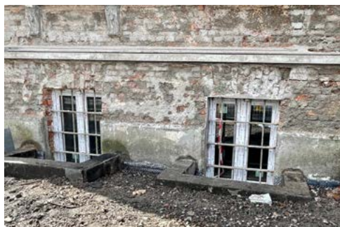
ryc. 3 Nieprawidłowy remont budynku historycznego powoduje jego zawilgocenie (uszczelnienie piwnic poprzez montaż okien z PVC oraz blokada w odprowadzaniu wilgoci w postaci folii, którą obłożono fundamenty)
