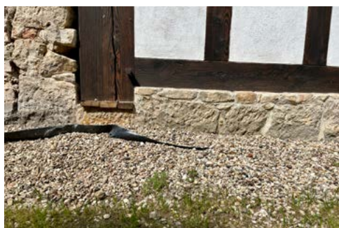
ryc. 1 Budynek w konstrukcji szkieletowej ryglowej, niedawno remontowanego ze środków z dotacji samorządowej – niekorzystna ingerencja w grunt przy budynku i wadliwie założona folia przyczynią się do zawilgocenia przegród
