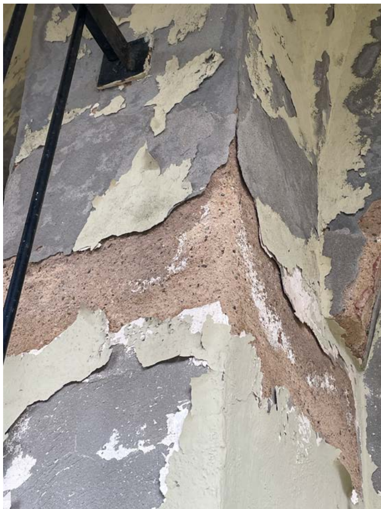
ryc. 4 Właściciel konsekwentnie nakłada na tynki piaskowo-wapienne warstwę zaprawy z cementem i syntetyczne, nie-przepuszczające pary wodnej farby, choć budynek wyraźnie komunikuje mu, że ich nie toleruje
