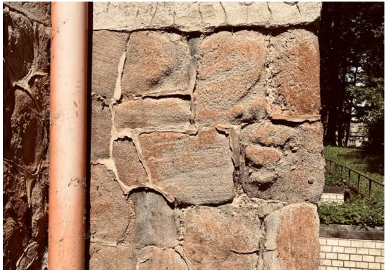
ryc. 5 Przykład nieprawidłowo opracowanej spoiny z wykorzystaniem niedopuszczalnego materiału – cementu
