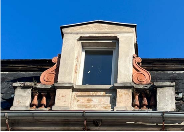
ryc. 6 Zabytkowy budynek z II poł. XIX w., którego wartość spadła poprzez zastosowanie nieodpasowanej stolarki okiennej
