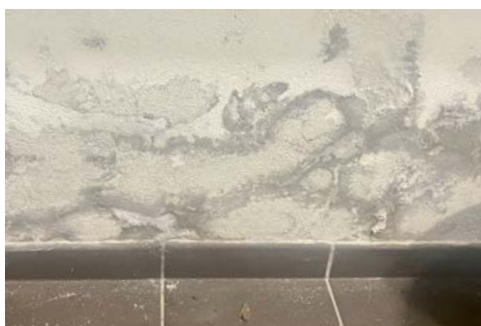
ryc. 2 Ściana w historycznym budynku w kilka lat po przeprowadzonych pracach budowlanych. Uszkodzenie wypraw tynkarskich jest wynikiem kilku złych decyzji: wprowadzenia ogrzewania do budynku zaprojektowanego jako nieogrzewany, zastosowania zamkniętych dyfuzyjnie materiałów do termomodernizacji oraz również zamkniętej dyfuzyjnie powłoki tynkarskiej z zaprawą z zawartością cementu
