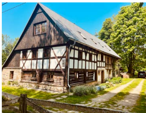
ryc. 10 Przykład różnych konstrukcji ścian w obrębie jednego założenia: ściany zrębowe, szkieletowe, słup wzmacniający oraz konstrukcja murowana kamienno-ceglana
