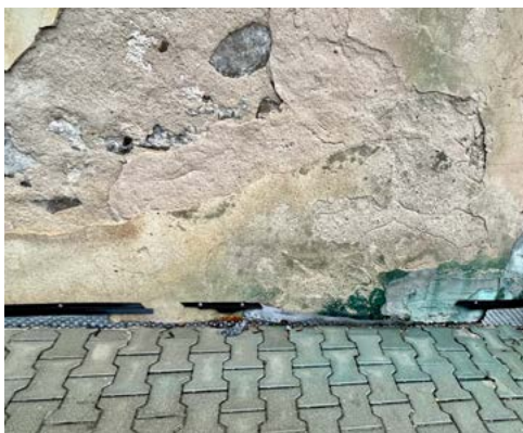
ryc. 9 Zawilgocenie partii cokołowej muru kościoła, m.in. wskutek obkopania ścian i naruszenia pierwotnej izolacji, obłożenia fundamentów folią, która miejscami już oddzieliła się od muru, prowizoryczne łatanie powstałych luk zaprawą cementową
