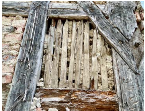
ryc. 15 Przykład uszkodzenia szkieletu ściany ryglowej poprzez długotrwałą ekspozycję na działanie wilgoci spowodowaną zablokowaniem jej odparowania poprzez tynki cementowe
