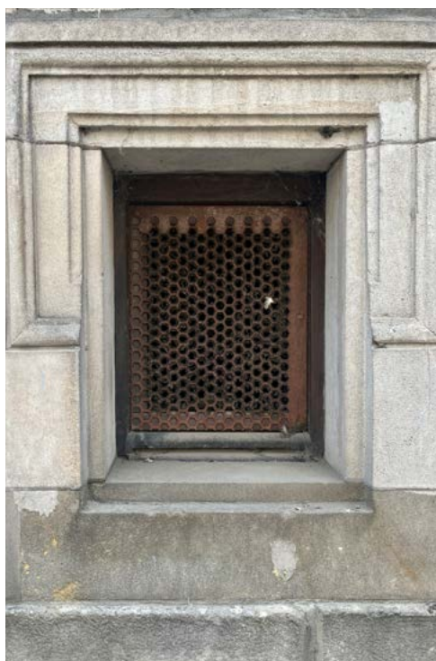
ryc. 7 Kratka służąca do wentylacji stropu
