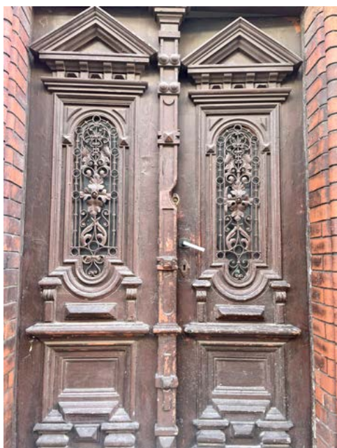
ryc. 3 Coraz rzadszy widok – zachowana oryginalna stolarka drzwiowa kamienicy z lat 80. xix w.
