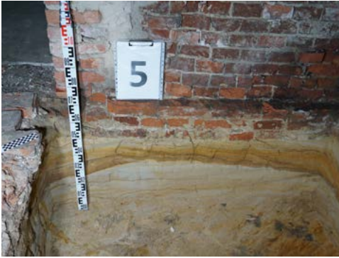
ryc. 3 Ściana fundamentowa murowana bezpośrednio na gruncie piaszczystym
