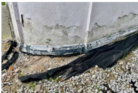
ryc. 4 Degradacja materiałów budowlanych w wyniku obłożenia fundamentów folią oraz zastosowania tynków z cementem
