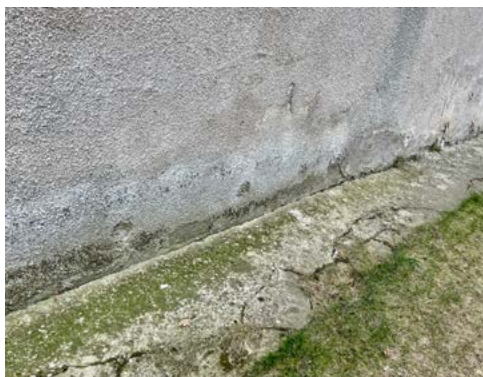
ryc. 10 Przykład degradującego wpływu opaski betonowej wokół budynku. Widoczne zawilgocenie samej opaski oraz partii cokołowej ściany
