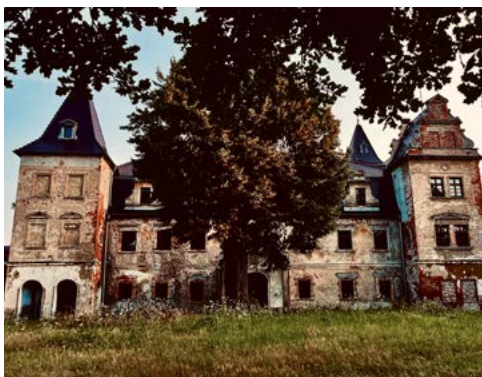
ryc. 11 Przy zabytkowych budynkach często spotykamy drzewa. Chronią dom przed zbytnim nasłonecznieniem latem, a dawniej przyjmowały również funkcję piorunochronu. Pomiędzy budynkiem a drzewem wykształciła się równowaga wilgotnościowa. Usunięcie lub uszkodzenie drzewa doprowadzi do jej zachwiania. Pałac w Nowiźnie, Dolny Śląsk
